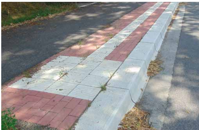
Fehlerhafte Ausrichtung der Rippenplatten
