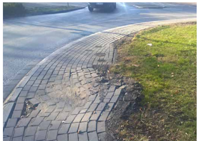
Schaden bei ungebundener Pflasterbauweise
