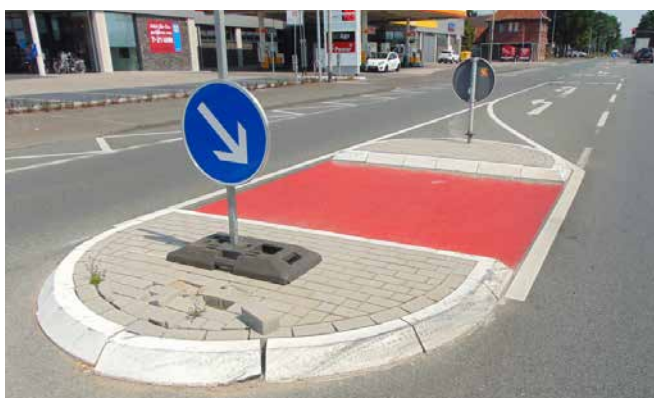
Schaden an einer herkömmlichen Querungsinsel
